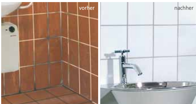
Ein möglicher Grund für eine Badrenovierung: Schimmelbildung aufgrund abgenutzter oder beschädigter Fliesen.
